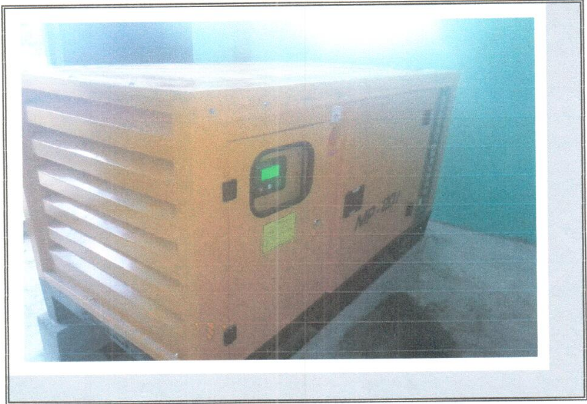
VISTA DEL GRUPO ELECTROGENO FUNCIONANDO
