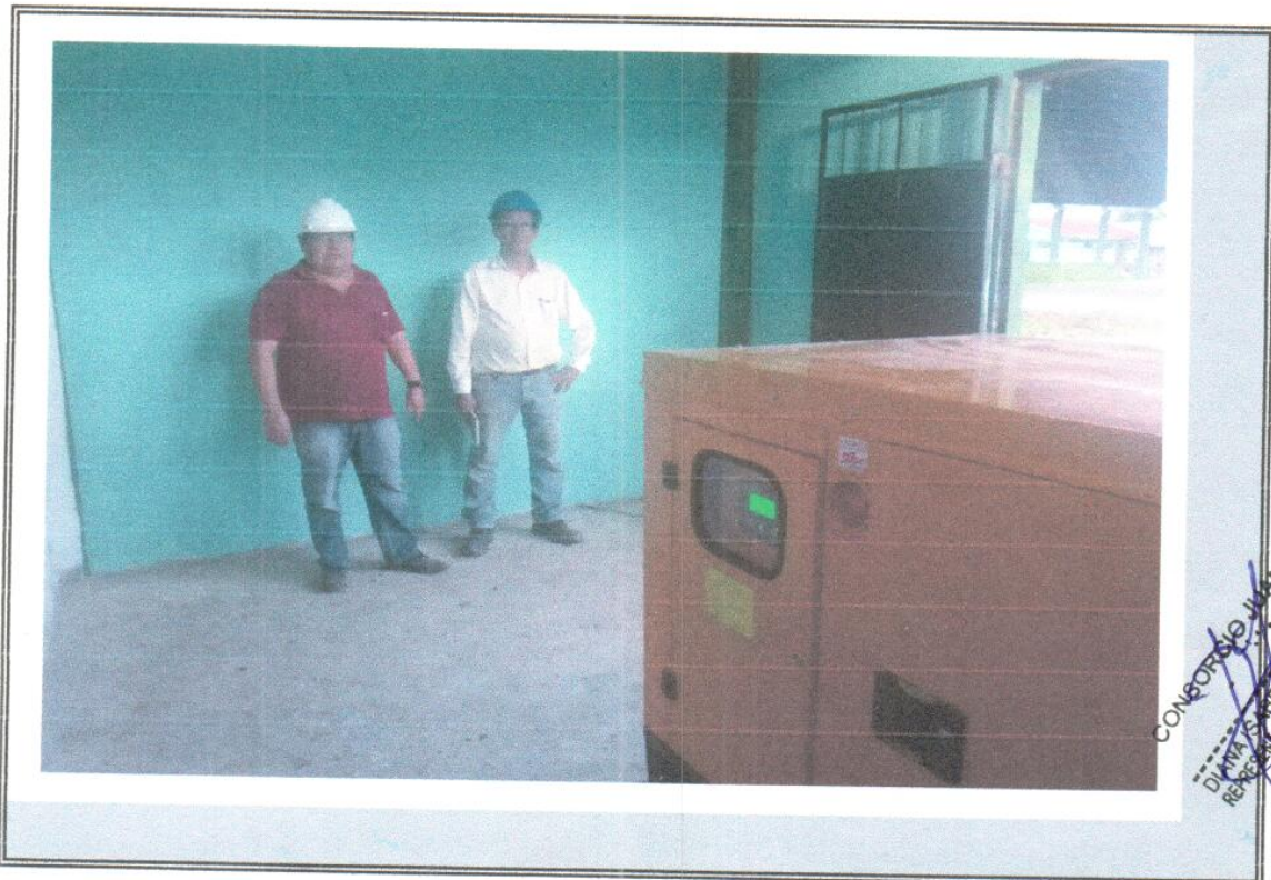
VISTA DEL GRUPO ELECTROGENO FUNCIONANDO CONSORCIO JUANCITO
