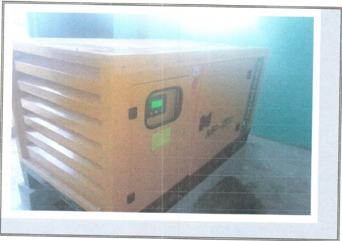
VISTA DEL GRUPO ELECTROGENO FUNCIONANDO
